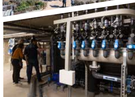
Visite des nouvelles installations techniques nécessaires au bon fonctionnement de l'équipement
